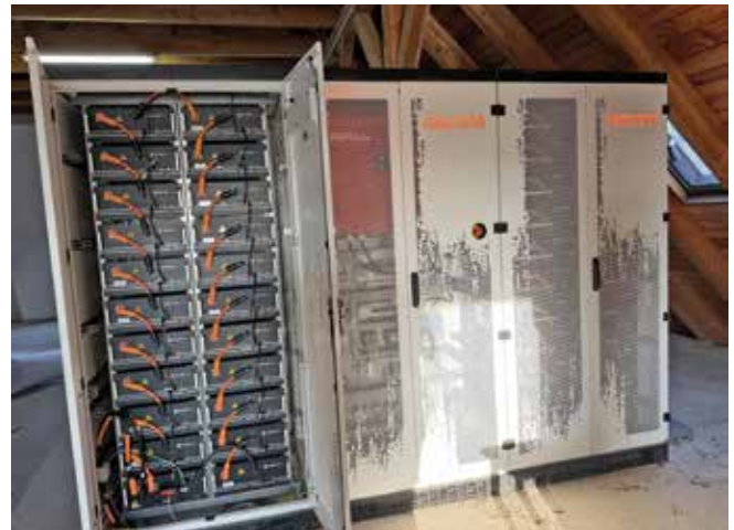
Foto: Neuer zusätzlicher 100 KW Stromspeicher auf der Kläranlage Ardagger
