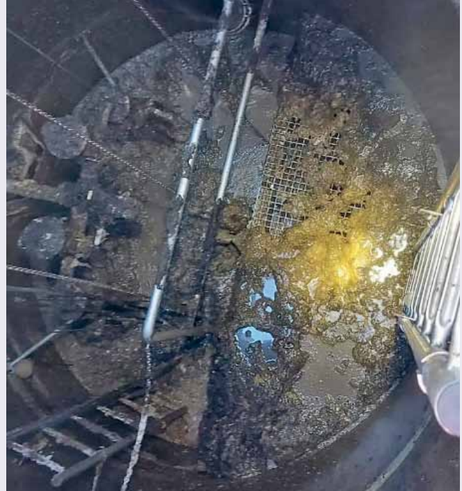
Foto: So können Küchenabfälle, Fette und Öle die Pumpen der Kanalpumpwerke oder auch der Kläranlage verstopfen!
